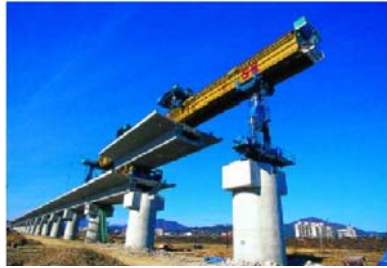
Figura 4 – Tabuleiro constituído por uma viga caixão pré-fabricada: vão de 25m, peso de 600 ton.
