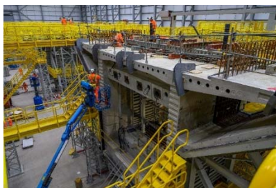
Figura 7 – Primeiro segmento dos 1000 que constituem o tabuleiro do viaduto ferroviário de Colne Valley.
