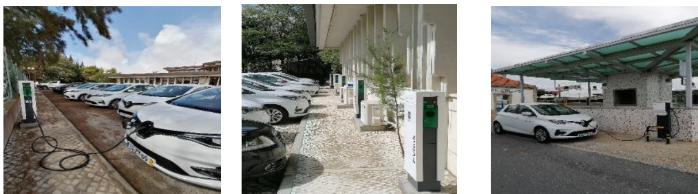
Figuras 3, 4 e 5 – Exemplos de postos de carregamento e veículos elétricos e híbridos plug-in , nas instalações da IP
