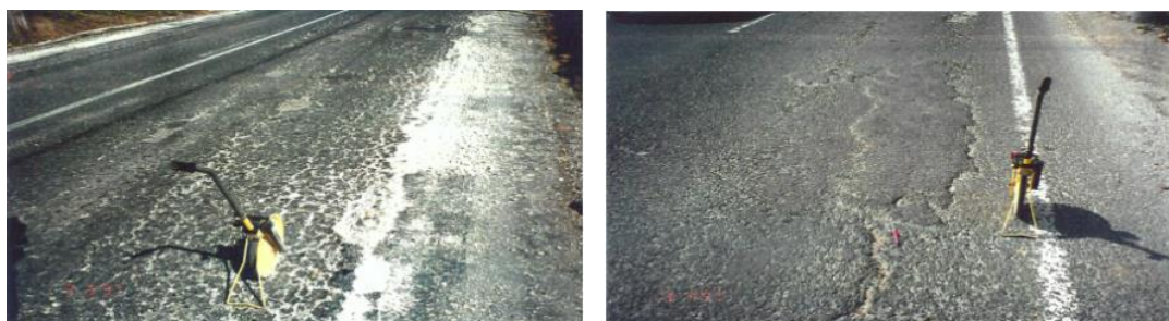
Figura 3. Pele de crocodilo (nível elevado) e reparação mal-executada, respetivamente
