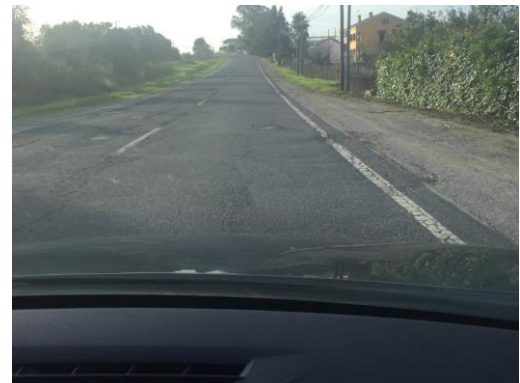
Figura 4 – Estado geral do troço da EN10 [5]
