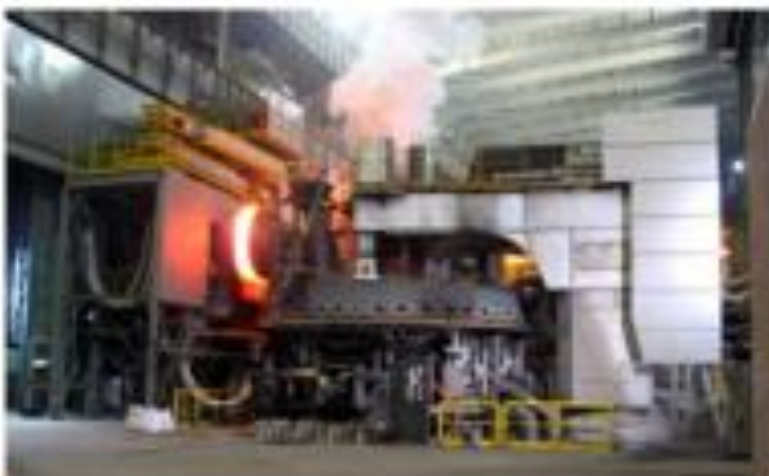
Horno de arco eléctrico
